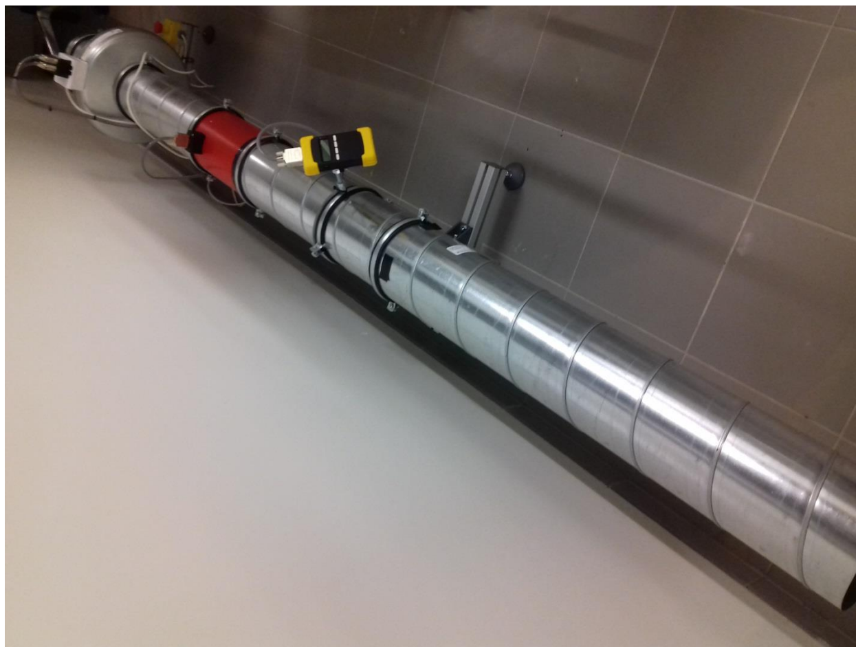
Joonis 3. OÜ Tauria poolt valmistatud väike ventilatsioonistend, mis ühendati lauaplaadis oleva avaga lehrimeetodil õhuvoogude mõõtmiseks
