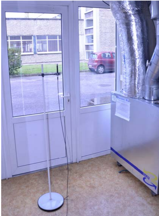
Foto 7. Ventilatsiooniagregaat SV1 tuulekojas ja statiivile kinnitatud mõõtemikrofon 1,5 m kõrgusel.
